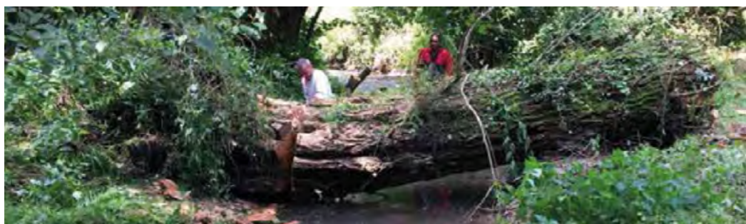
Dégagement d'un tronç en travers d'un ruisseau (Ruisseau d'Asse)
